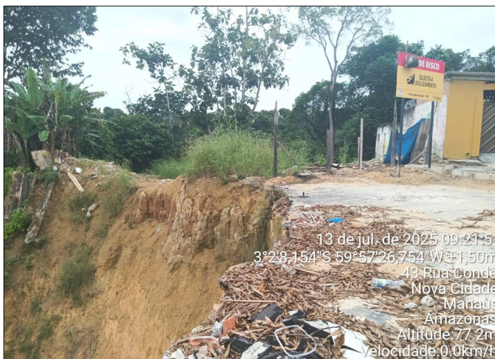
Figura 22 Deslizamento de Massa no Bairro Novo Aleixo. Fonte: Autores, 2025.
