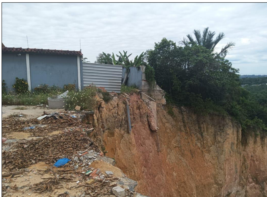
Figura 23 Residências habitadas próximo a Deslizamento de Massa, bairro Novo Aleixo. Fonte: Autores, 2025.
