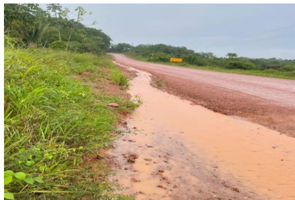
Figura 17 - Escoamento lateral de águas pluviais pela encosta. Fonte: Autor (2026).
