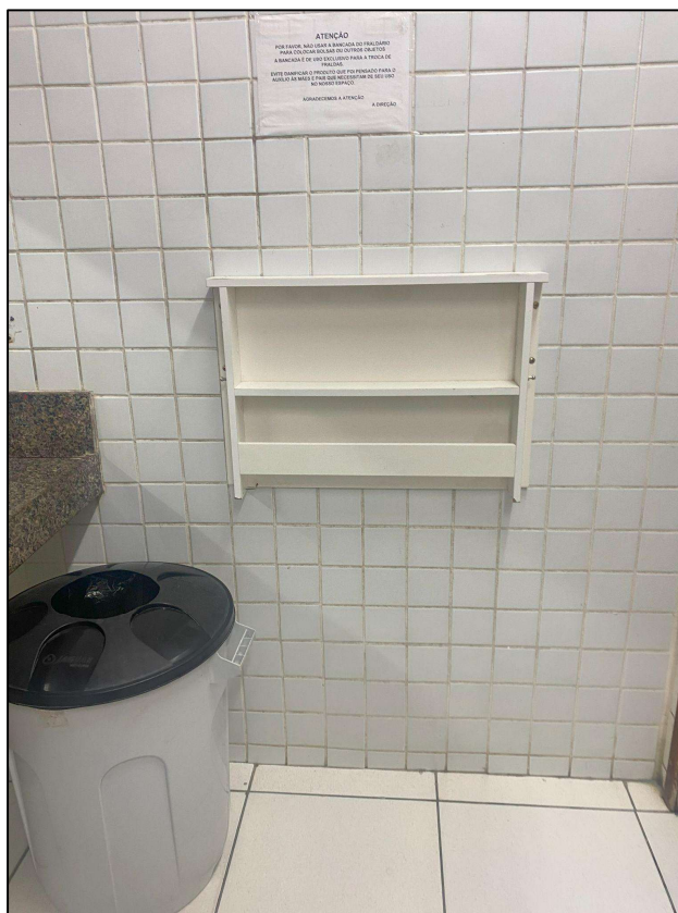
Figura 18 - Fraldário danificado no banheiro feminino na FACED Fonte: arquivo próprio (2026)
