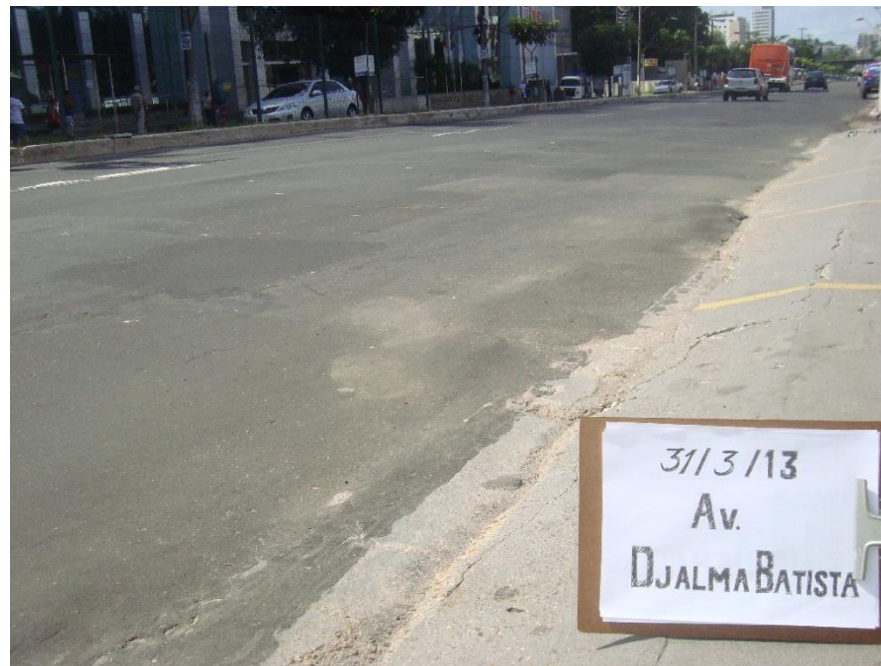
Figura 28 - Remendos e deformações, observados no pavimento.
