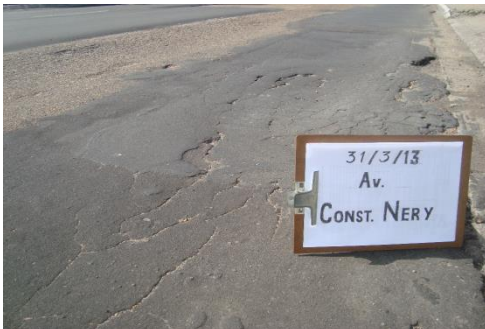
Figura 21 - Deformações no pavimento.
