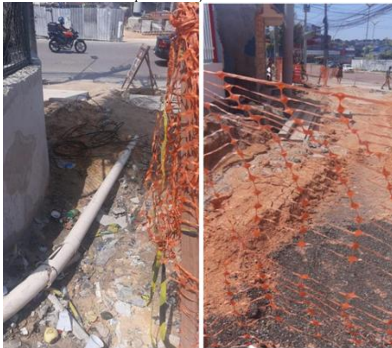
Figura 47 - Transtornos causados pela construção do Viaduto Rei Pelé na Feira da Zona Leste
