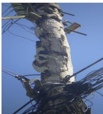
Figura 8 - Poste perfurado devido à ação de cupins. Fonte: OLIVEIRA, P.V.C, 2008.
