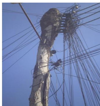
Figura 9 - Ninho de cupim próximo à fiação. Fonte: OLIVEIRA, P.V.C, 2008.
