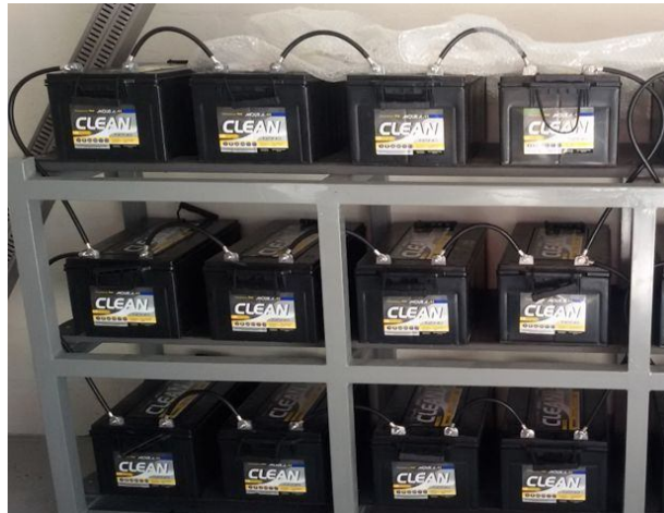
Figura 68. Vista parcial do banco de acumuladores.
