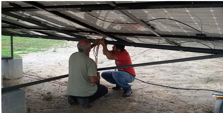
Figura 64. Ligações elétricas dos painéis.
