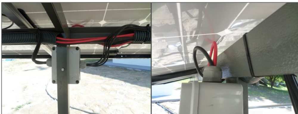
Figura 66. Vista dos condutores chegando ao barramento.
