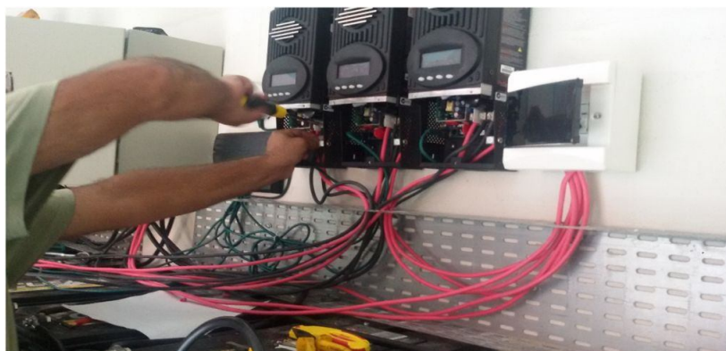
Figura 70. Conexão dos condutores nos controladores de carga.
