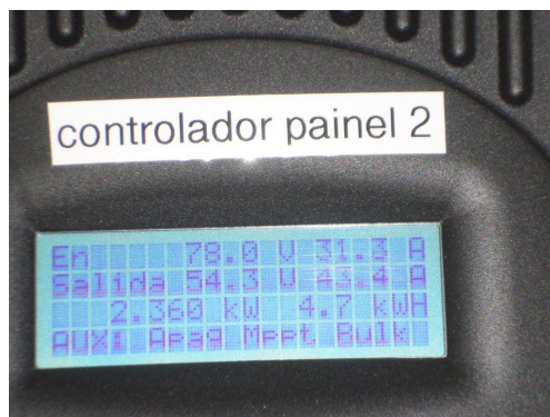
Figura 76. Parâmetros elétricos do controlador de carga 2.
