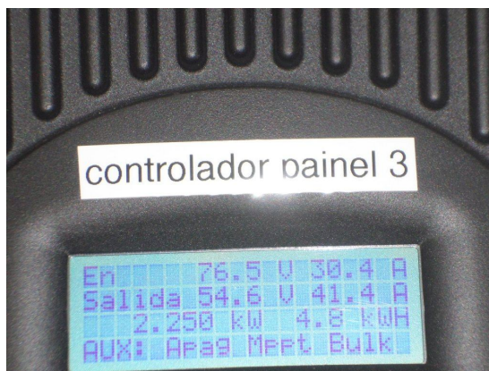
Figura 77. Parâmetros elétricos do controlador de carga 3.
