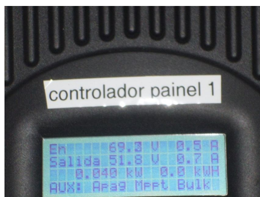
Figura 81. Parâmetros elétricos do controlador de carga 1 em um dia chuvoso.
