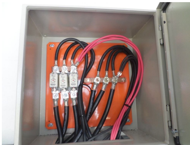
Figura 69. Quadro de fusíveis, para proteção do sistema.
