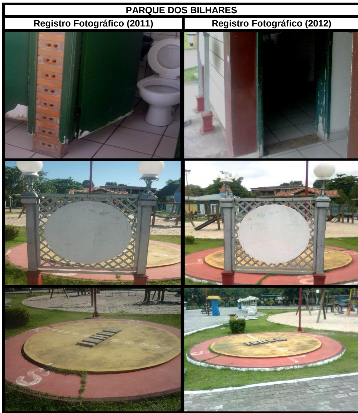
FIGURA 20: Processo de Deterioração do Parque dos Bilhares.
