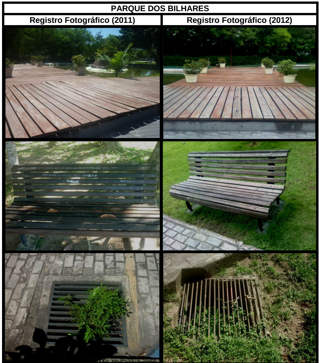
FIGURA 22: Processo de Deterioração do Parque dos Bilhares.
