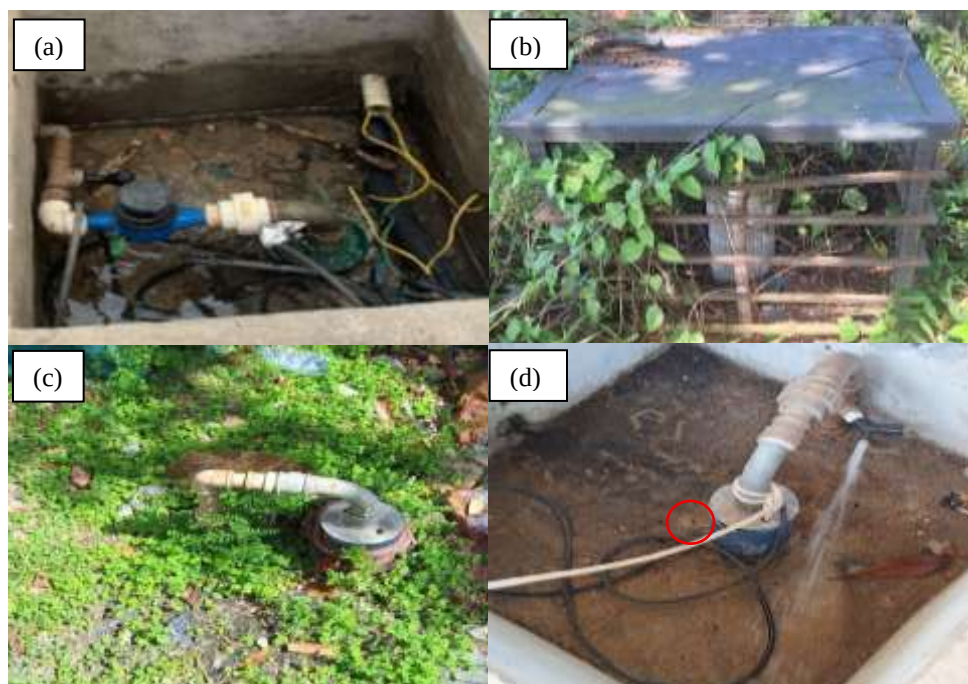
Figura 31 - Condições estruturais observadas nos poços amostrados: (a) compartimento interno com acúmulo de água; (b) estrutura de proteção com presença de vegetação densa e vedação lateral insuficiente; (c) poço instalado diretamente no solo, sem base impermeável.
