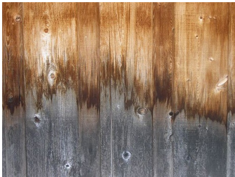
Figura 1- Aspecto da madeira degradada fisicamente. Fonte: WOOD ANATOMY, acesso em 2007.
