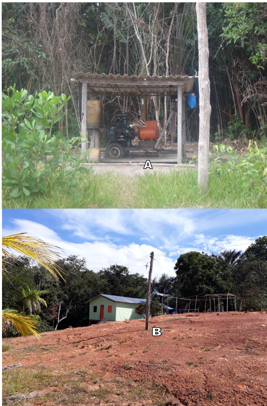
Figura nº 10 – Gerador de energia da Comunidade (A) e fiação de energia elétrica, proveniente do linhão(B).
