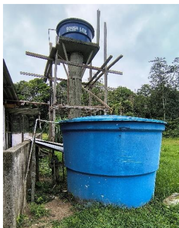
Figura 27 - Abastecimento de Água
