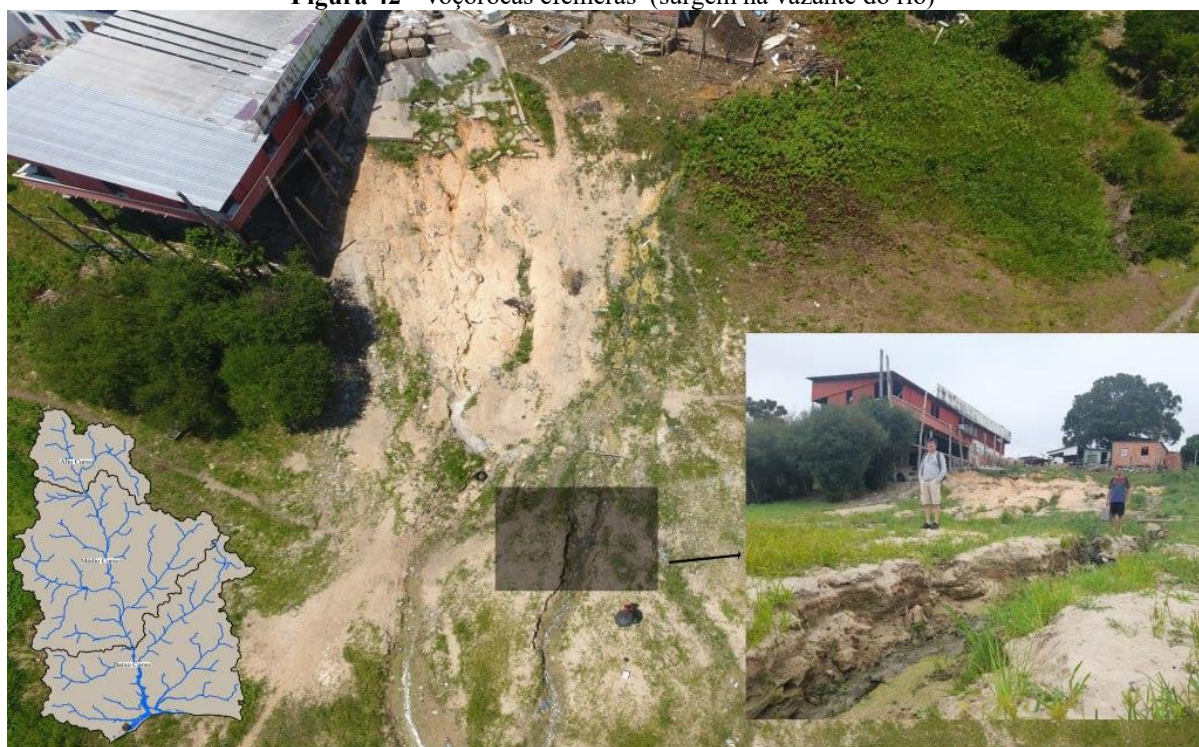
Figura 42 - Voçorocas efêmeras (surgem na vazante do rio)
