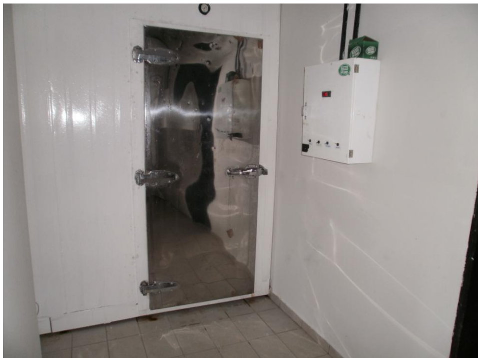
Figura 4: Câmara de armazenamento do CSNAM com capacidade de 7 toneladas. Fonte: (Pesquisa de Campo, 2011)
