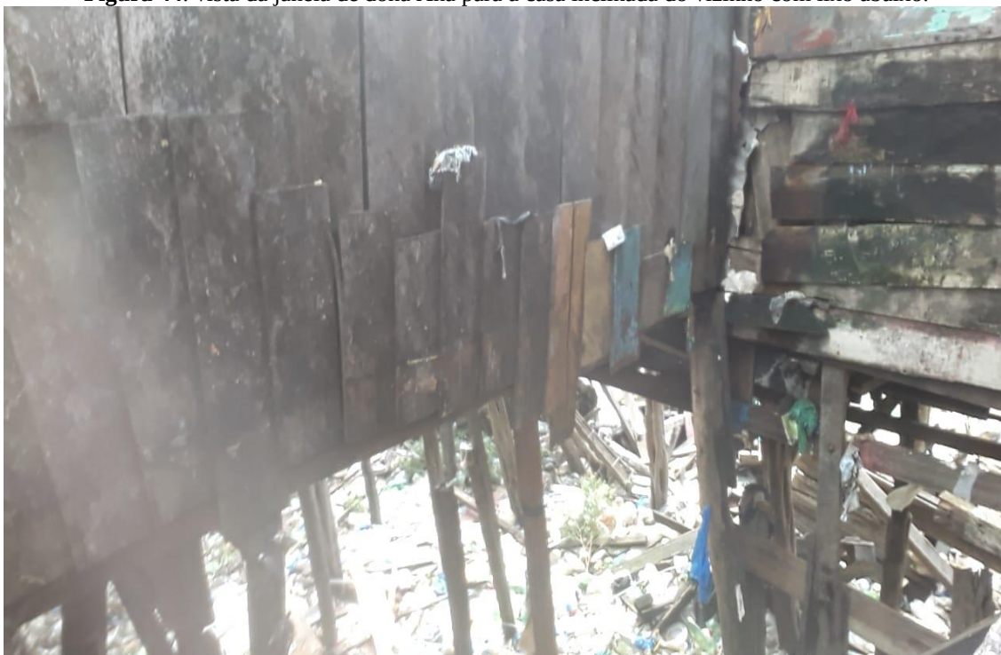
Figura 44: vista da janela de dona Ana para a casa inclinada do vizinho com lixo abaixo.
